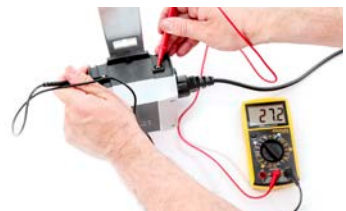
Spanning op de lader controleren
