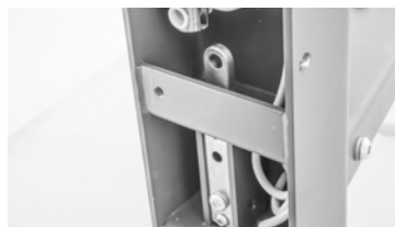
Bild efter att ställdonet fränkopplats
